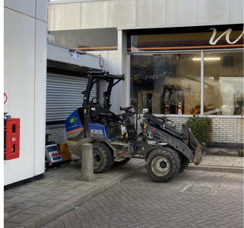
Voorbeeld inzet indirect stroompunt (tankstation)
